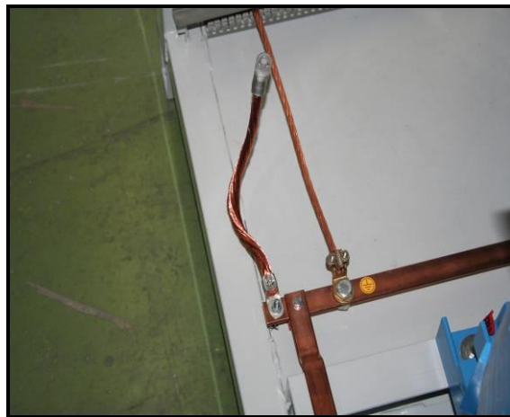
Fig.13.- Conexión tierra entre módulos
